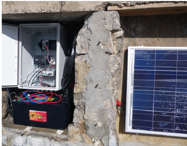
FIGURE 5.5 – Photo du panneau solaire et de l’installation électrique intégrée dans la digue.
